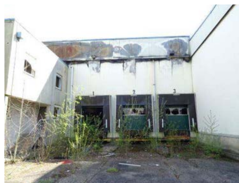
Une friche urbaine aujourd'hui devenue dangereuse suite à un incendie
