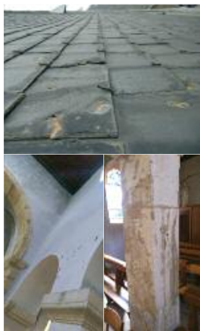
Etat actuel de la toiture, des piliers et des peintures intérieurs
