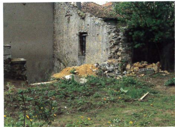
L'arrière de la maison en ruine.
