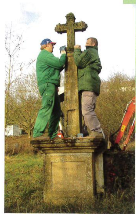
Michel Pierret et Jean Surowaniec, de l'équipe technique municipale, démontent le monument pièce par pièce.
